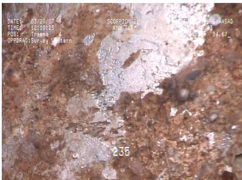
Figur 1. Korrosjon på bart område på babord bakkdekk.
