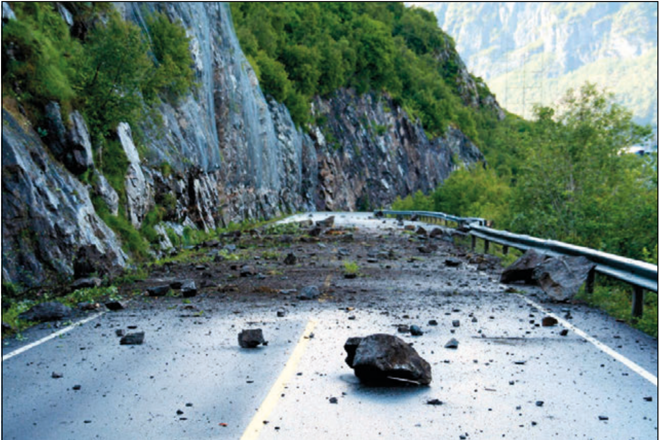
Figur 14.1 Skred på riksveg 70 Oppdølstranda, Møre og Romsdal.
