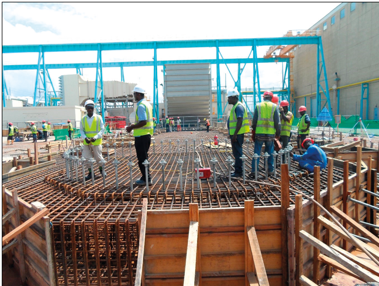
Figur 3.2 Ghana, Takoradi. Utvidelse av eksisterende kraftanlegg med finansiering fra PIDG. Dette gir anlegget kapasitet til å gi 8,9 millioner flere mennesker tilgang til strøm.
