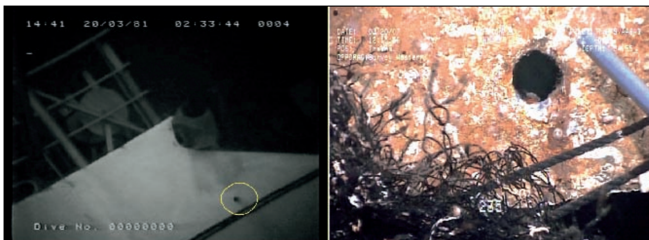
Figur 6.9 Stillbilde med mørk flekk på babord trålbakk innringet og påvist hull babord side ved filming i 2007.
