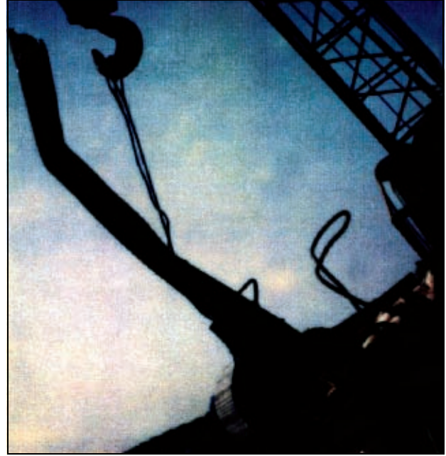
Figur 6.22 Den midterste del av masten var kraftig deformert (delvis nesten flatklemt).
