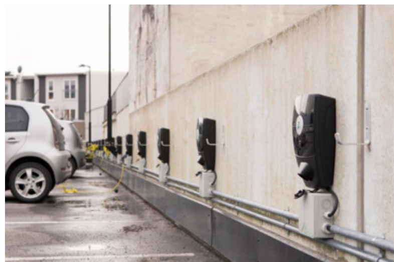
Figur 8: Norske Zaptecs ladesystem for elbiler. Foto: Zaptec
