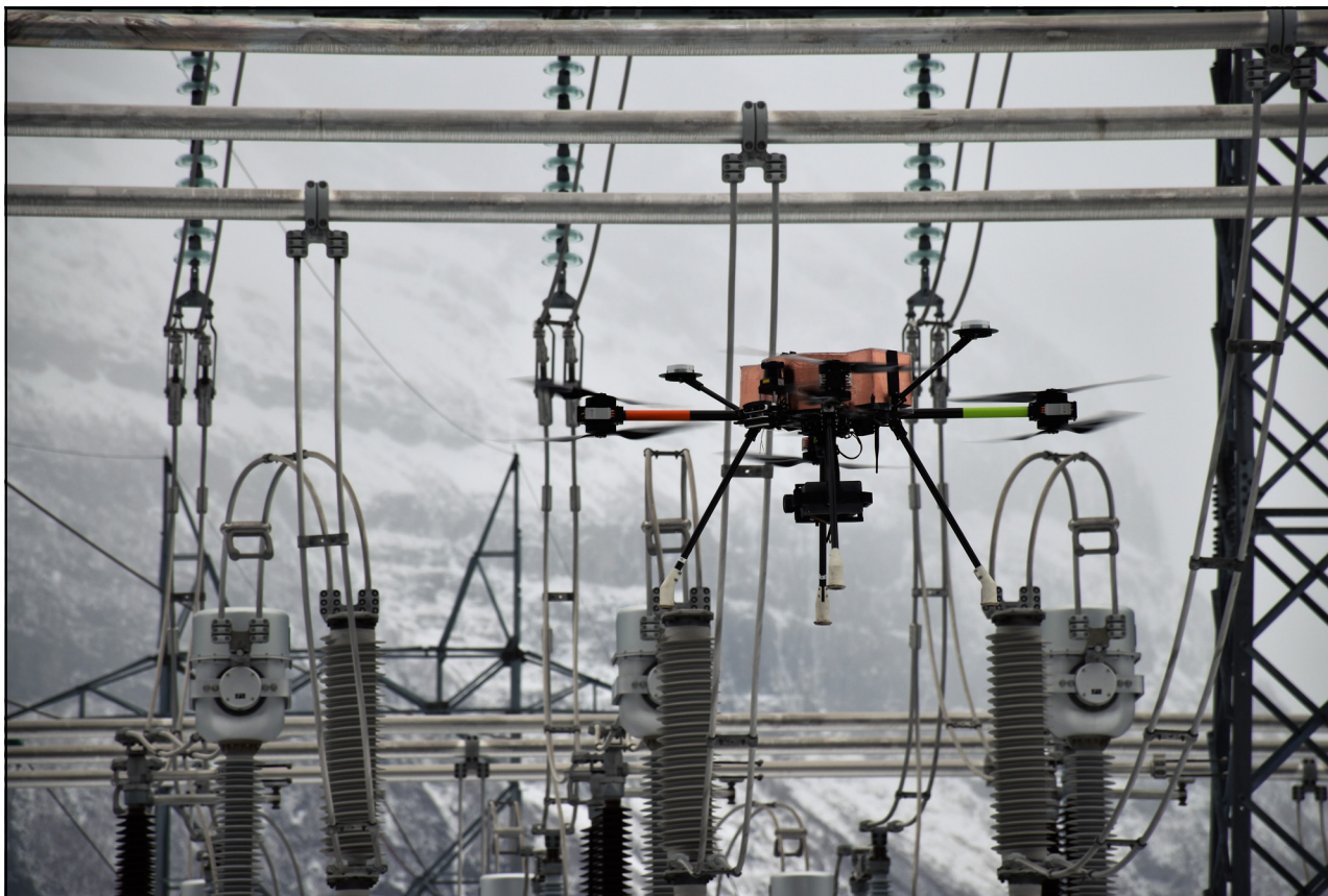
Figur 2.6 Avlesing av målere på transformatorstasjon med drone
