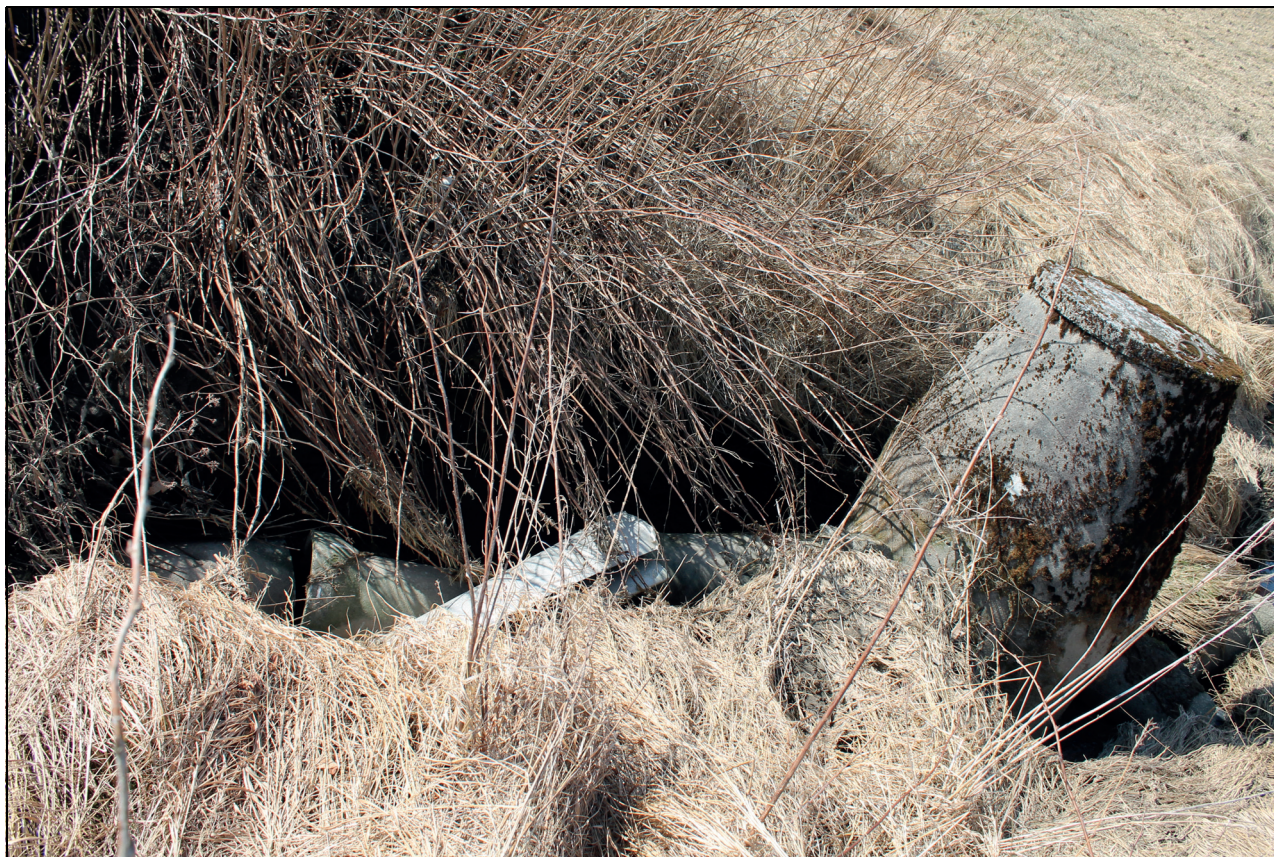
Figur 10.2 Erosjon i ødelagte hydrotekniske anlegg starter i det små, og kan ende med store skader.
