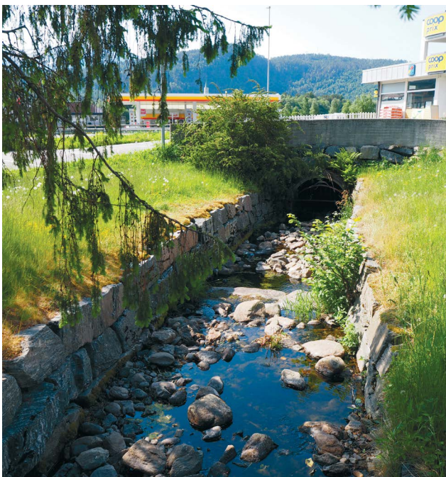
Wenzellelva i rør kan åpnes for å danne åpen overvannshåndtering i nye boligområder
