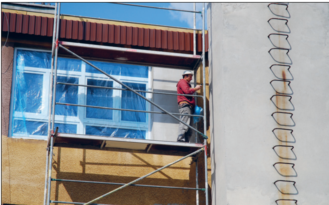
Figur 3.1 Energieffektivisering av bygninger er blant de mest effektive tiltakene for å redusere utslipp av klimagasser. Her fra Busko-distriktet i Polen hvor sju skolebygg ble etterisolert og fikk nye vinduer og dører.
