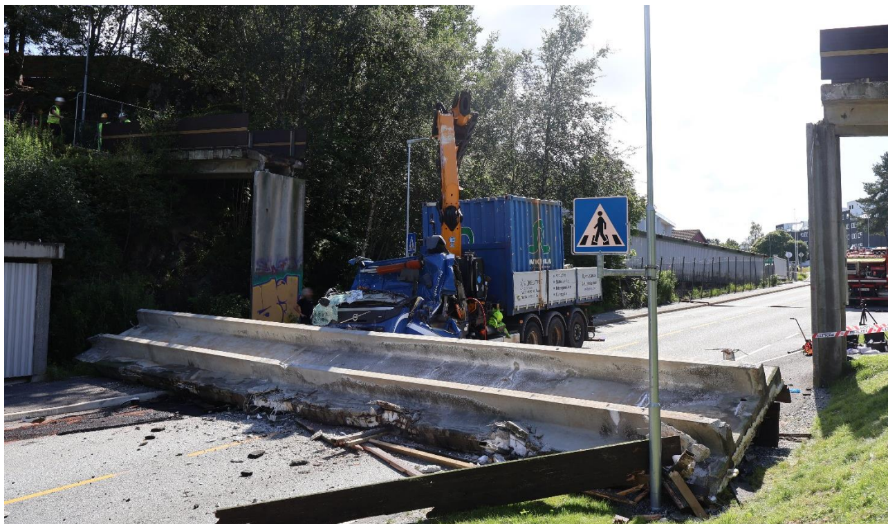
Ulykkesstedet på fylkesvei 5210 i Bergen 31. juli 2023. Foto: Statens vegvesen
