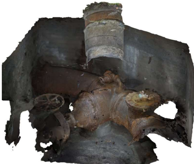
Figur 2. Gjengivelse av armatur i vannkum SID 208016 ved fotogrammetri. Figuren illustrerer hovedvannledningen hvor det er plassert en horisontal sluseventil mellom to flensebend.
